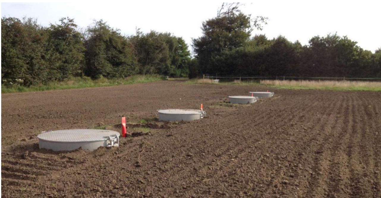
Figur 7 Eksempel på teknikbrønde (linkboksbrønd) ved fire parallelle kabelsystemer. Ved siden af står røde markeringsstandere. Placering og behov for markering vil være en konkret vurdering i de enkelte tilfælde.
