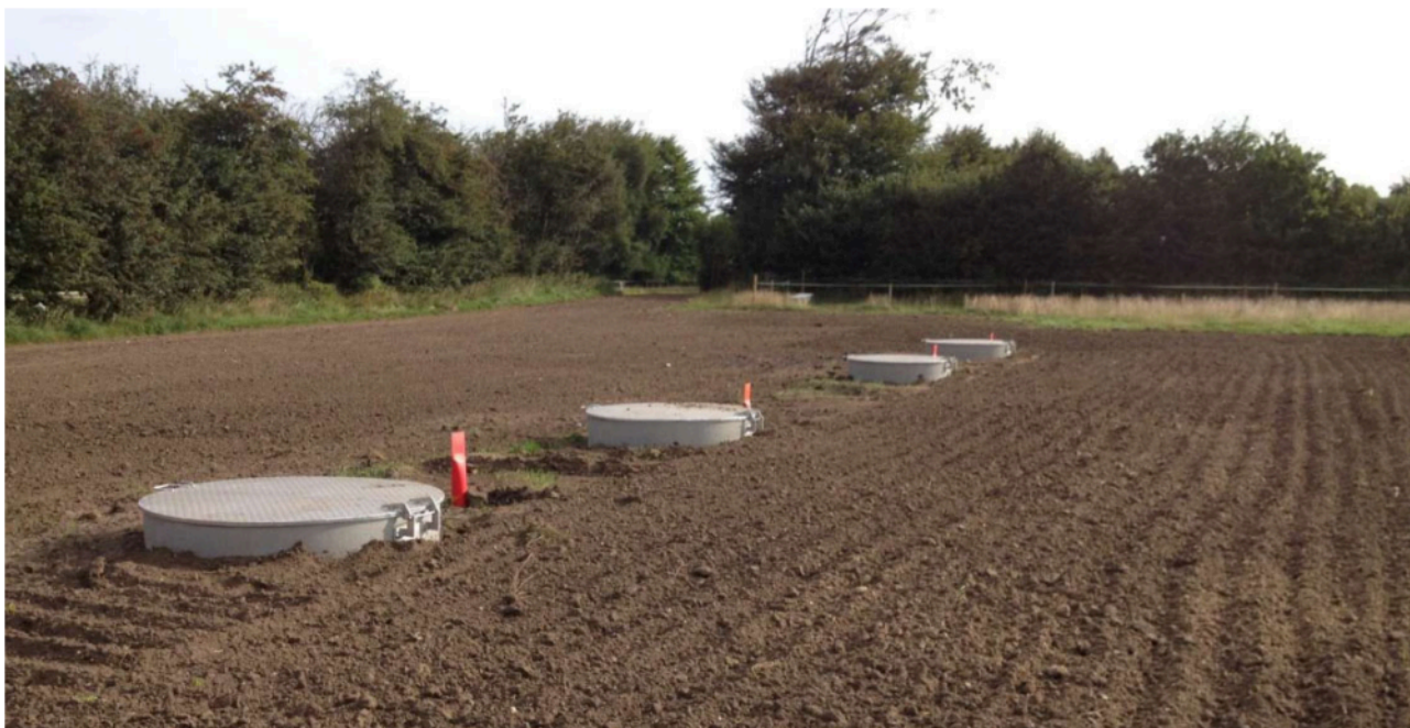
Figur 7 Eksempel på teknikbrønde (linkboksbrønd) ved fire parallelle kabelsystemer. Ved siden af står røde markeringstandere. Placering og behov for markering vil være en konkret vurdering i de enkelte tilfælde.
