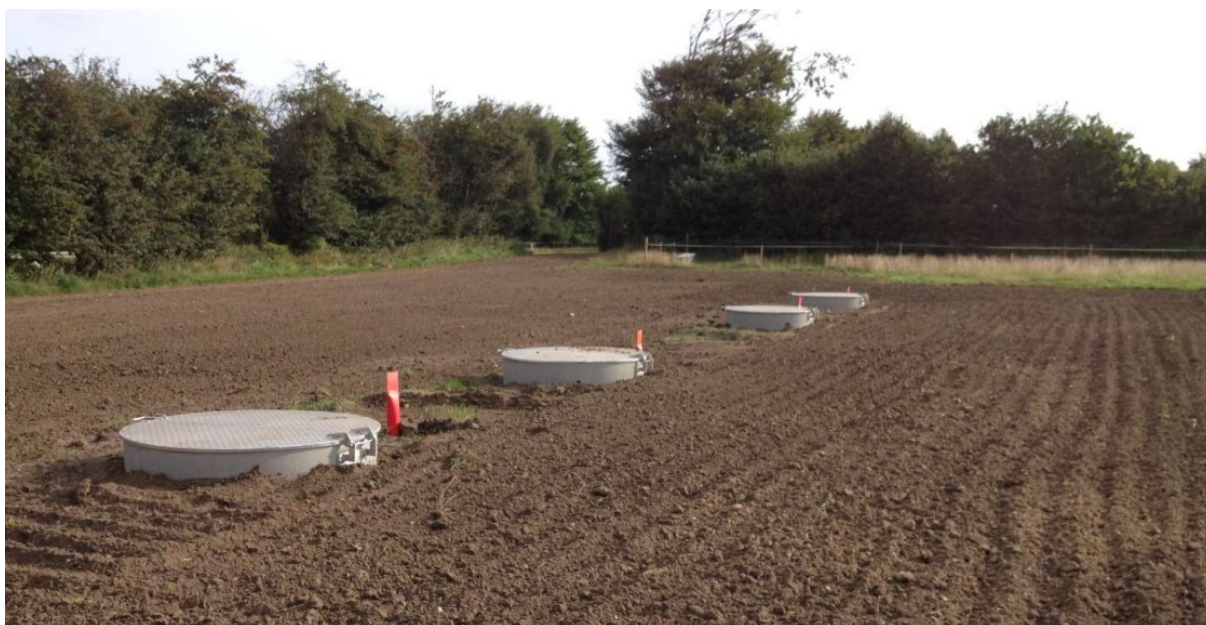
Figur 7 Eksempel på teknikbrønde (linkboksbrønd) ved fire parallelle kabelsystemer.
