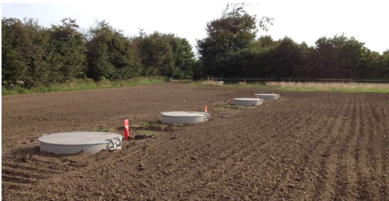
Figur 7 Eksempel på teknikbrønde (linkboksbrønd) ved fire parallelle kabelsystemer. Ved siden af står røde markeringsstandere. Placering og behov for markering vil være en konkret vurdering i de enkelte tilfælde.
